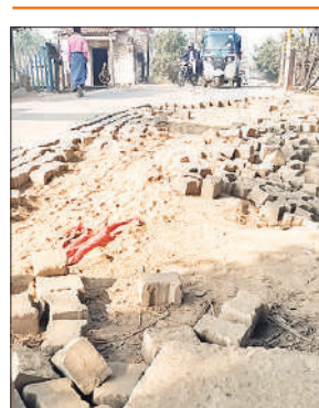
टूटी पड़ी सड़क।
