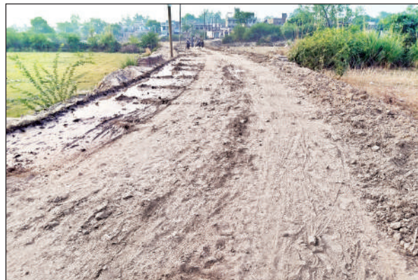
पोनी रोड की इस तरह खुदी पड़ी है सड़क ।
