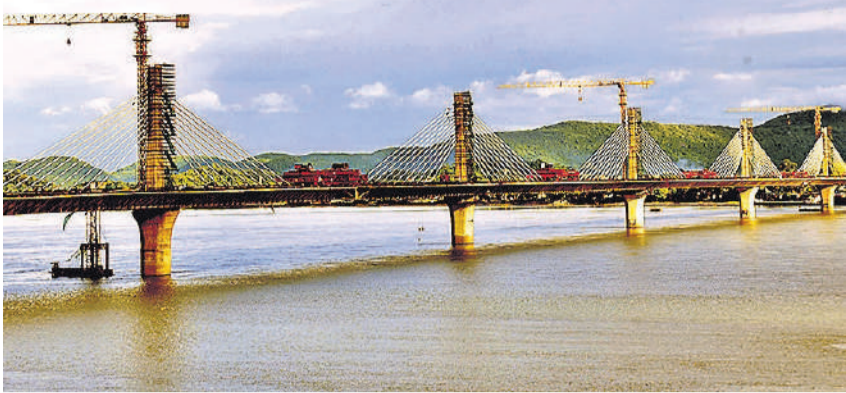
गुवाहाटी में ब्रह्मपुत्र नदी पर गुवाहाटी को उत्तरी गुवाहाटी से जोड़ने वाले छह लेन के हाईटेक एक्सट्राडोज़ पुल का निर्माण कार्य चल रहा है। करीब 2,608.68 करोड़ रुपये लागत के इस पुल का निर्माण मार्च 2026 में पूरा होने की उम्मीद है। लम्बायम 1.24 किलोमीटर लंबाई का यह देश का पहला एक्सट्राडोज़ पुल होगा।
