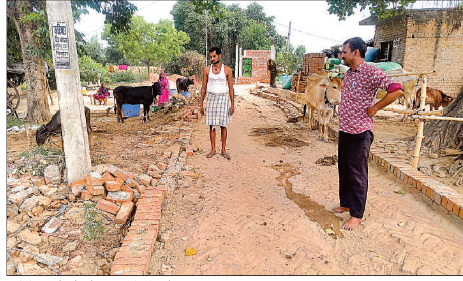
बनने से पहले ही टूटी पड़ी सड़क को देखते ग्रामीण।
