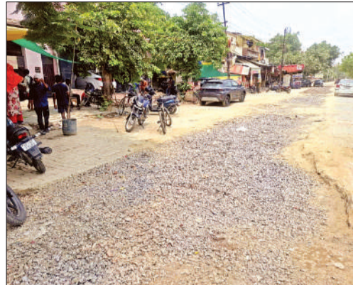
उस्मानपुर जाने वाली मुख्य सड़क पर मिट्टी डालकर छोड़ दी गई सड़क।
