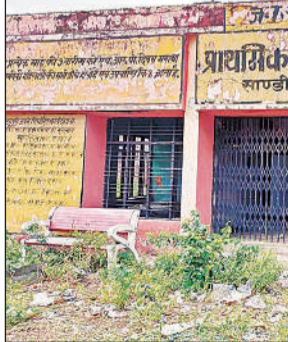
जर्जर भवन में तब्दील हो रही प्राथमिक स्वास्थ्य केंद्र भवन।
