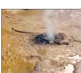
केस्को की अंडरग्राउंड केबिल जलने से निकलती धुआं।
