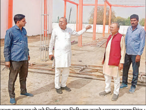
कथा स्थल पर हो रहे निर्माण का निरीक्षण करते भगवान बरखा सिंह ।
