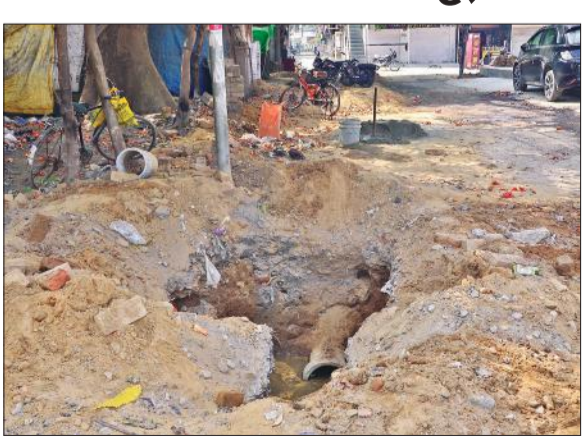
सीवर लाइन बिछाने के लिए खोदी गई सड़क पर बना गड्डा।
