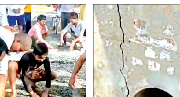
सड़क की गुणवत्ता दिखाते ग्रामीण। हाल ही में निर्मित पुलिया में पड़ी दरार।
