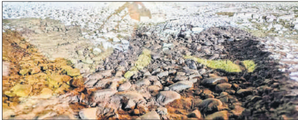
रेड सफायर के सामने टूटी सड़क।
