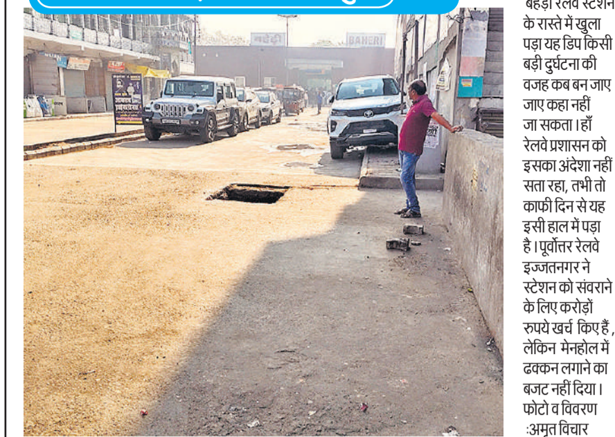
बहेड़ी रेलवे स्टेशन के रास्ते में खुला पड़ा यह डिप किसी बड़ी दुर्घटना की वजह कब बन जाए जाए कहा नहीं जा सकता। ही रेलवे प्रशासन को इसका अंदेश नहीं सता रहा, तभी तो काफी दिन से यह इसी हाल में पड़ा है। पूर्वोत्तर रेलवे इञ्जलतमगर ने स्टेशन को संवराने के लिए करोड़ों रुपये खर्च किए हैं, लेकिन मेन्हेल में ढक्कन लगाने का बजट नहीं दिया। फोटो व विवरण : अमृत विचार
