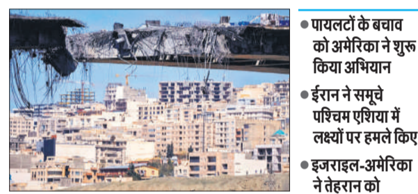
ईरान के कराज शहर में हवाई हमलों से क्षतिग्रस्त हुआ पुल।
