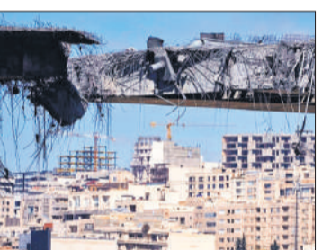
कराज शहर में हवाई हमलों से क्षतिग्रस्त हुआ पुल।
