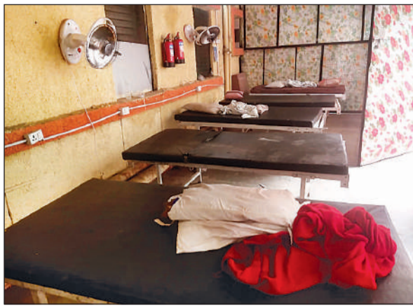
बद्दहाल रैन बसेरा में पंखे की जगह लगे हीटर।
