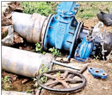
खराब पड़ी जैतपुर की पाइप लाइन।
