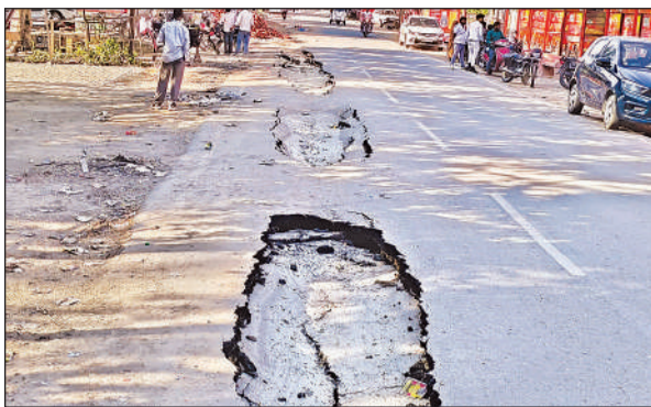
सिविल लाइन्स में भाजपा कार्यालय के निकट धंसी सड़क।
