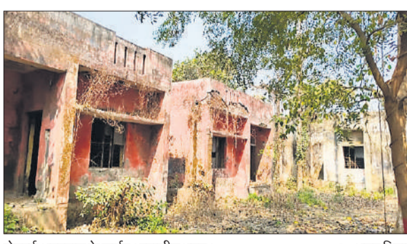
सेमरई अस्पताल के जर्जर आवासीय भवन।
