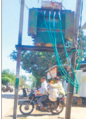
अजान में सड़क के किनारे खुले में रखा ट्रांसफार्मर।
