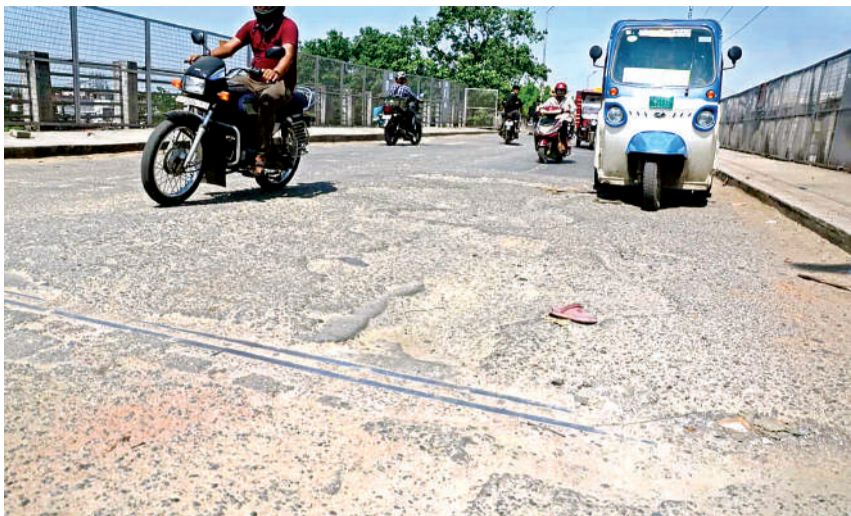
शहर के जर्जर पुलों से गुजरना मतलब जिंदगी को मौत की डगर पर चलने जैसा है। सीओडी पुल वर्ष 2020 में तथा श्याम नगर पुल वर्ष 2011 में निर्माण व उद्घाटन के पश्चात मात्र 06 से 15 वर्षों में ही पुल की सड़क में दरार आ गई। जगह-जगह गड्डे हो गए हैं। हिचकोले खाते पुल के लोहे के गाडर टूटकर जर्जर हो गए हैं। अब इन पुलों से गुजरने वाले राहगीरों की जान को खतरा बना है। विभाग ने पुल की इस हालत को देखने के बजाय आंखें बंद कर रखी हैं। फोटो - मनोज तिवारी
