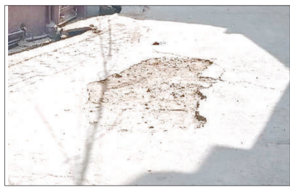
गली में सड़क में दिख रहे गड्ढे।
