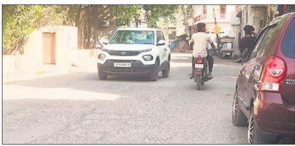
जीजीआईसी की ओर जाने वाली जर्जर सड़क।
