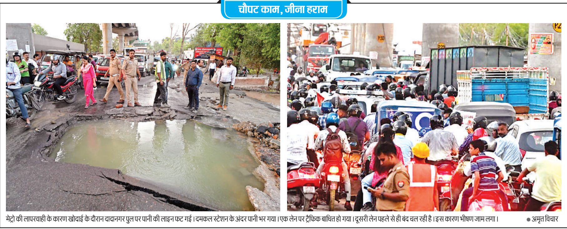
मेट्रो की लापरवाही के कारण खोदाई के दौरान दादानगर पुल पर पानी की लाइन फट गई। दमकल स्टेशन के अंदर पानी भर गया। एक लेन पर ट्रैफिक बाधित हो गया। दूसरी लेन पहले से ही बंद चल रही है। इस कारण भीषण जाम लगा।
