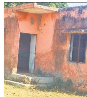
खिड़की, दरवाजे विहीन पीएचसी भवन।
