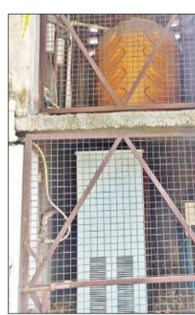
गोला के पब्लिक कॉलेज में खराब पड़ा वॉटर कुलर।
