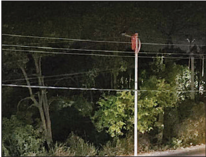
खराब पड़ी स्ट्रीट लाइटें।
