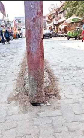
जर्जर बिजली का पोल। ● अमृत विचार
