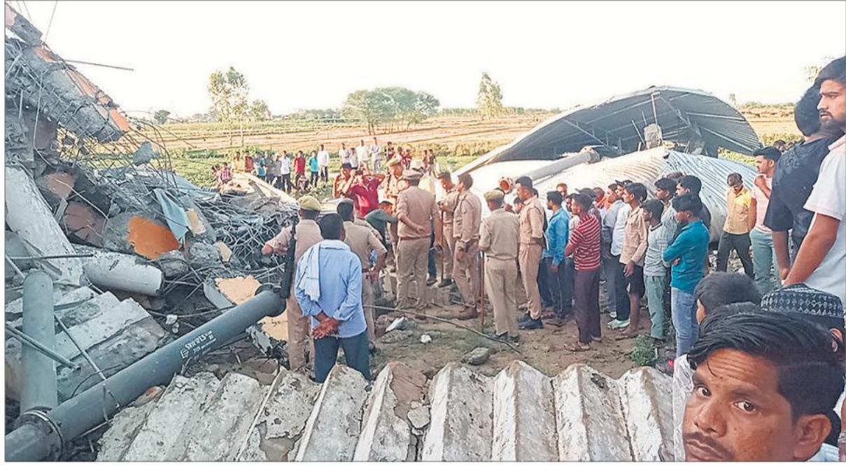
सरदारनगर ग्राम पंचायत में करोड़ों की लागत से बने ओवरहेड टैंक के गिरकर मलबे में तब्दील होने के बाद ग्रामीण और पुलिस कर्मी मौके पर पहुंचे। ● अमृत विचार
