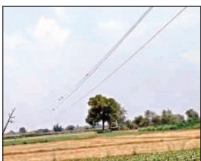
खेतों के ऊपर से गुजरी एचटी लाइन।
