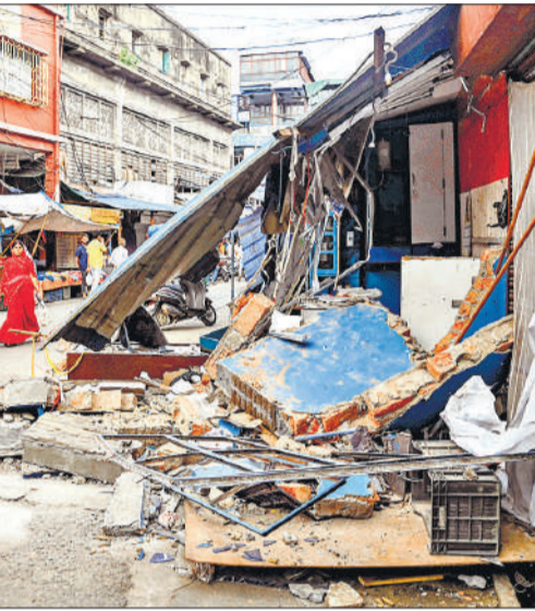
कोलकाता में बुलडोजर चलाकर ध्वस्त की गई एक दुकान।
