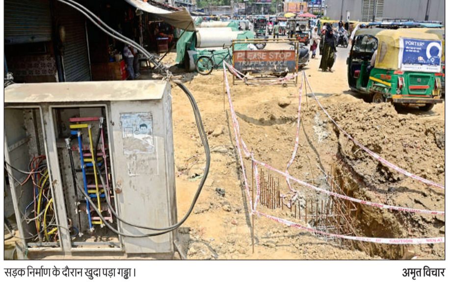
सड़क निर्माण के दौरान खुदा पड़ा गड़्डा।
