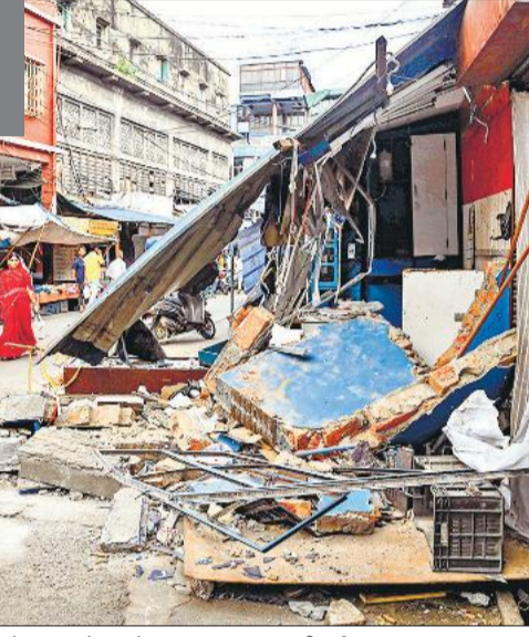
कोलकाता में बुलडोजर चलाकर ध्वस्त की गई एक दुकान।
