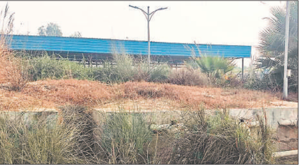
नगरपालिका की ओर से बनवाया गया एफएसटीपी प्लांट पड़ा टप।
