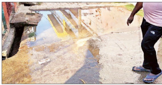
पेय जलापूर्ति की पाइपलाइन लीक होने से गली में हुआ जलभराव।
