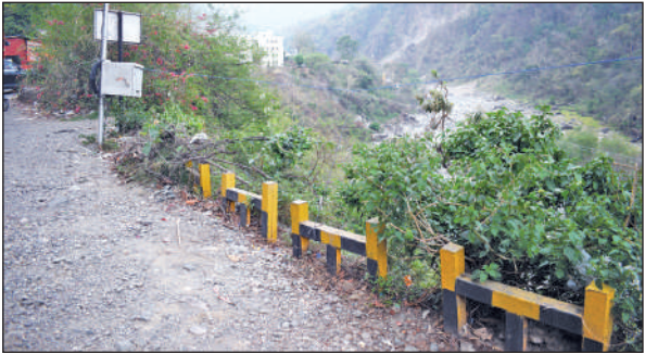
गुलाबघाटी के पास सड़क किनारे धंसे हुए पैराफिट हादसों का खतरा बढ़ा रहे हैं।
