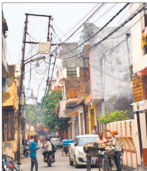
मोहल्ला इनायतगंज में मुख्य मार्ग पर जर्जर पोल।
