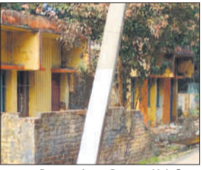
आवास विकास सेवन विभाग कॉलोनी की तरफ जर्जर पोल।
