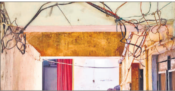
एक्सईएन दफ्तर के पास की गैलरी में जर्जर और झूलते खुले तार।
